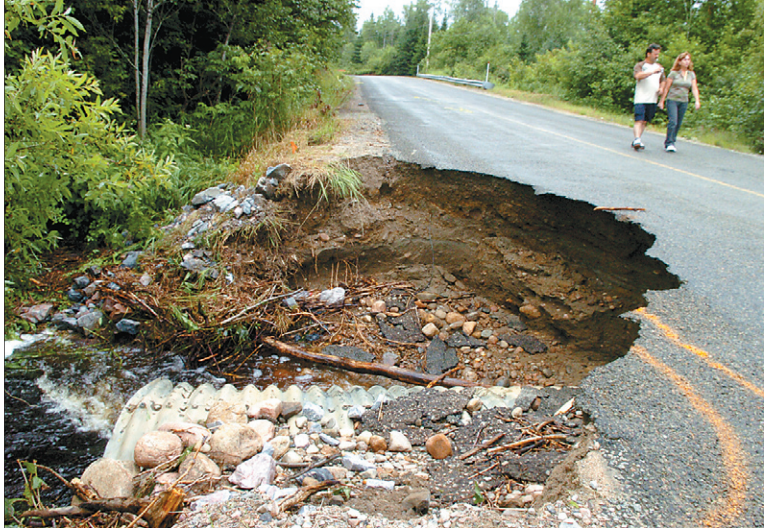
PHOTO: STÉPHANE LESSARD Le rang Sud-est a dû être interdit à la circulation automobile hier. Des trous comme celui-ci étaient visibles en plusieurs endroits.
