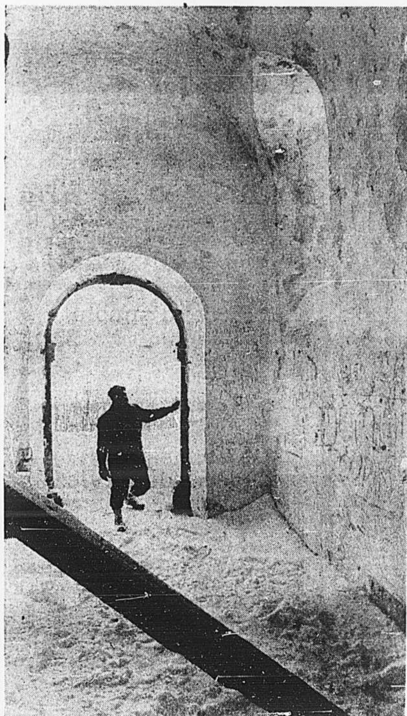
La chapelle principale présente un spectacle désolant: son autel et sa balustrade ont été démantelés, ses vitres ont été brisées et les murs sont couverts de graffiti.
