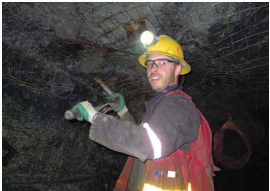
Un technicien minier de la mine Lac Herbin vérifie le torque des boulons.
