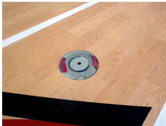
Un manchon d'ancrage encrassé empêche le couvercle de bien se refermer.
