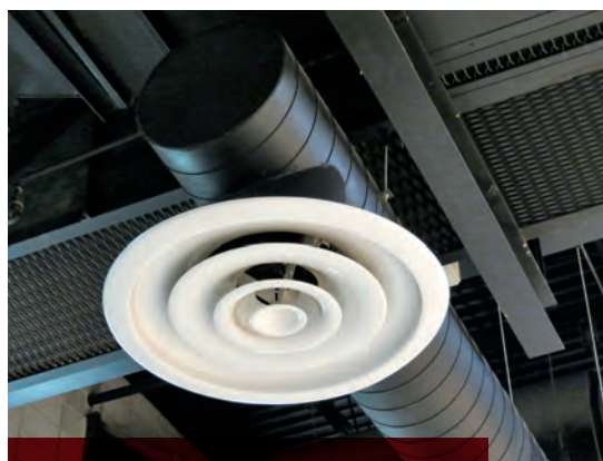
Avec ce diffuseur, la circulation de l'air ne gêne pas la pratique du badminton.
