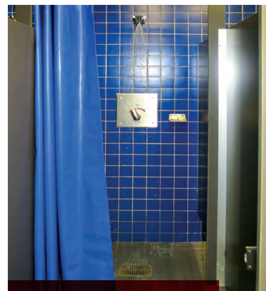
Voici un exemple de douche dont les matériaux sont faciles à entretenir. Celle-ci dispose d'un espace muni d'un petit banc pour le déshabillage. Un mitigeur doit limiter la température de l'eau au point de sortie à un maximum de 40 °C.
