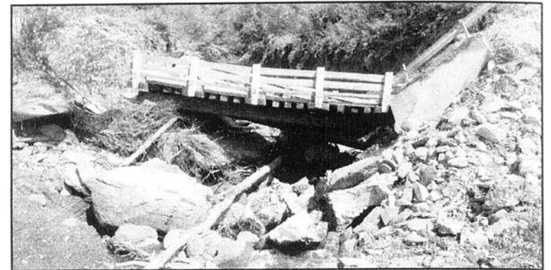
Dans le rang 1 nord de Saint-Martin, on a fabriqué un ponceau temporaire, pour contourner ce pont effondré.
