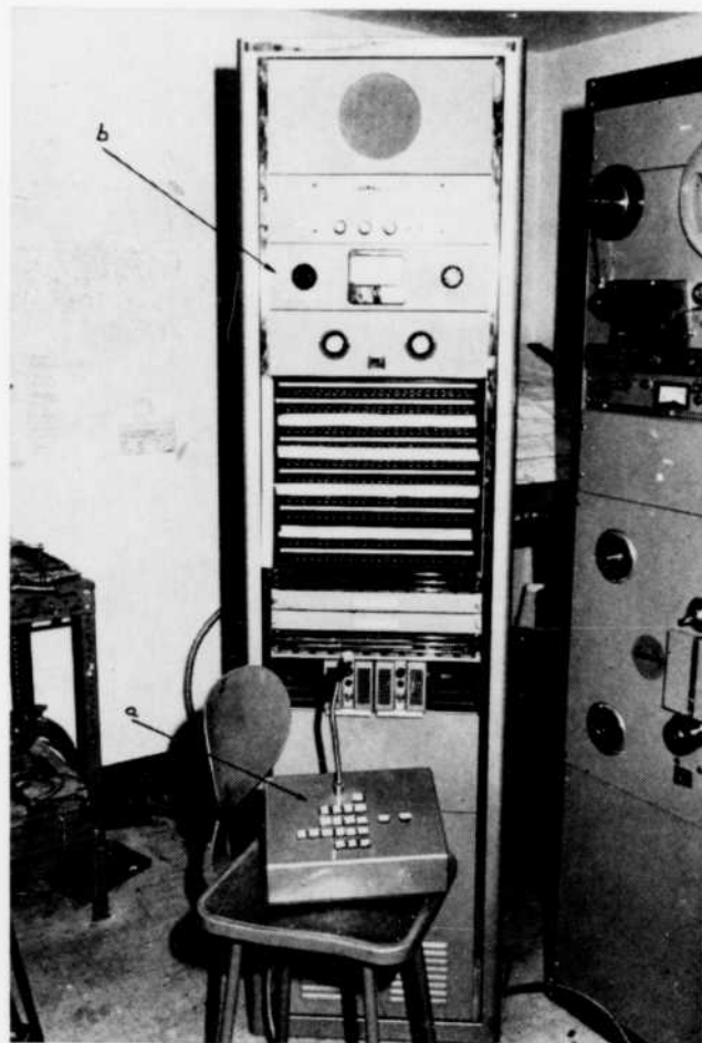
Systeme d'urgence Salle de contrôle
