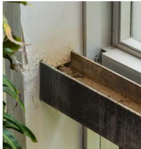
Détérioration de la poutre d'acier. Photo : Antoine Saito.
