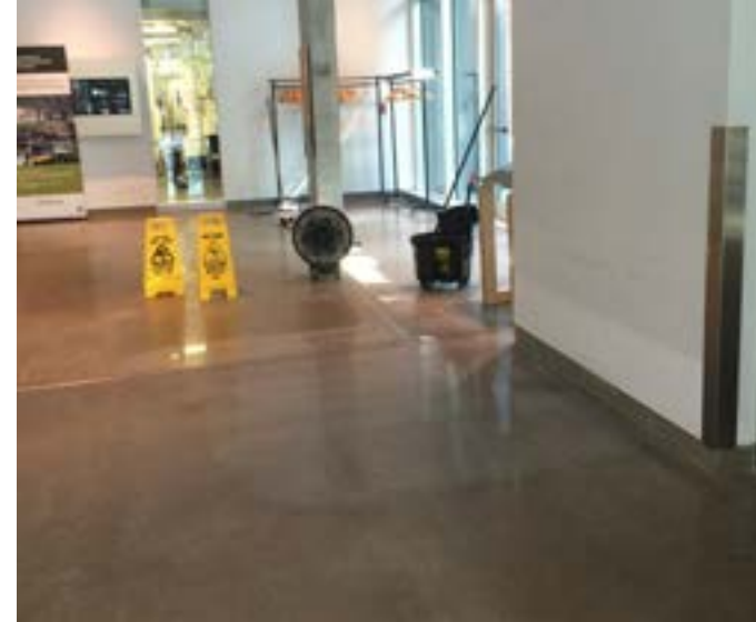
Tentative de nettoyage par polissage.
