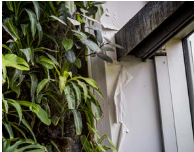
Détérioration peinture et gypse. Photo : Antoine Saito.
