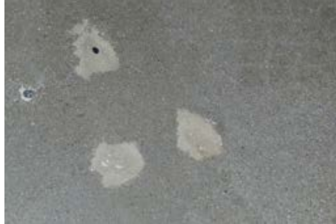
Tentative de réparation des cavités.
