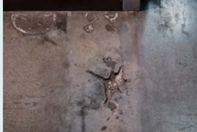
Marques laissées lors du déplacement d'un mur et de tuyaux de plomberie. Photo : Antoine Saito.
