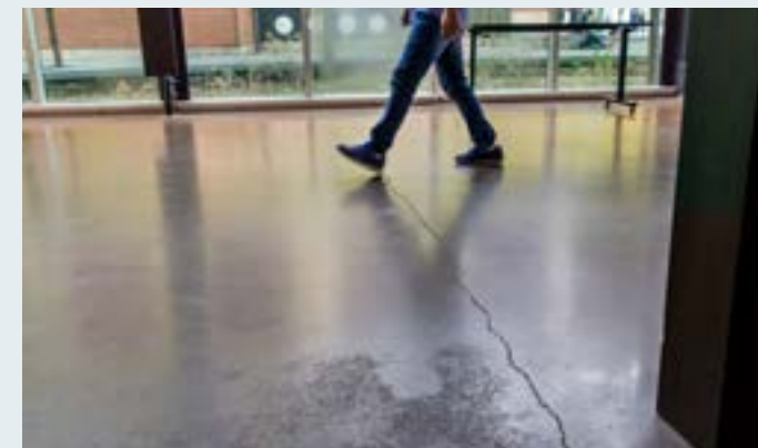
Fissure dans la dalle du rez-de-chaussée. Photo : Antoine Saito.
