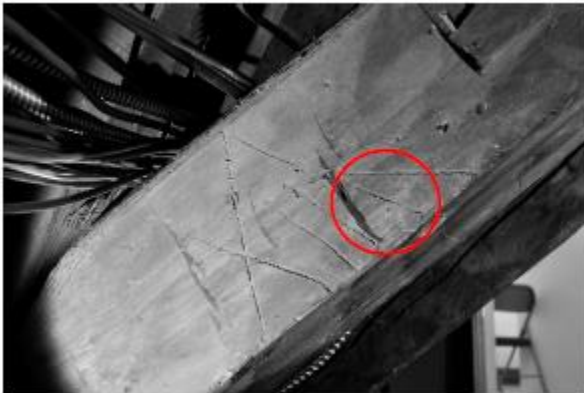
Photo 5 : Aisselier 17 (T-4) sud.
