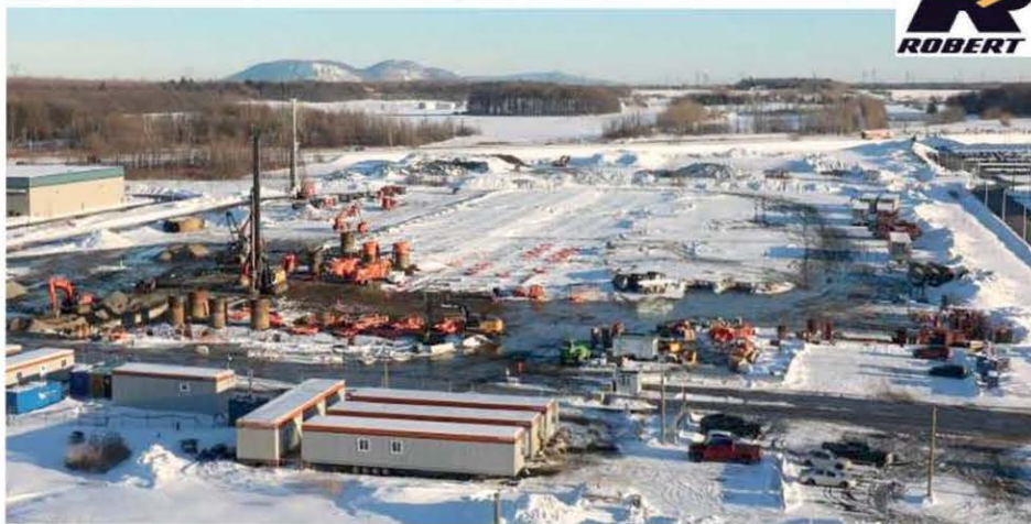
Le chantier du projet sur le terrain acquis par Groupe Robert à Varennes.
