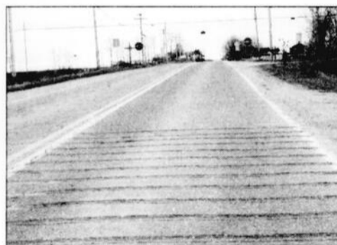
Des mesures ont été prises pour améliorer la sécurité à la dangereuse intersection.
