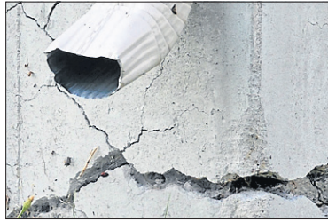
Les maisons touchées par la pyrrhotite seront évaluées à 40 % de leur valeur d'origine. — PHOTO: LE NOUVELLISTE
