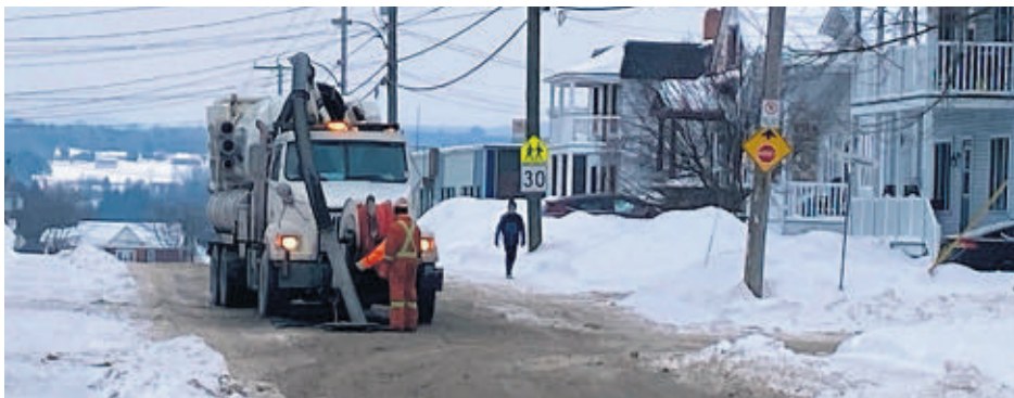
Un sous-traitant de la compagnie Sintra procède à la vérification des travaux sur la rue Ambroise-Dearden.
