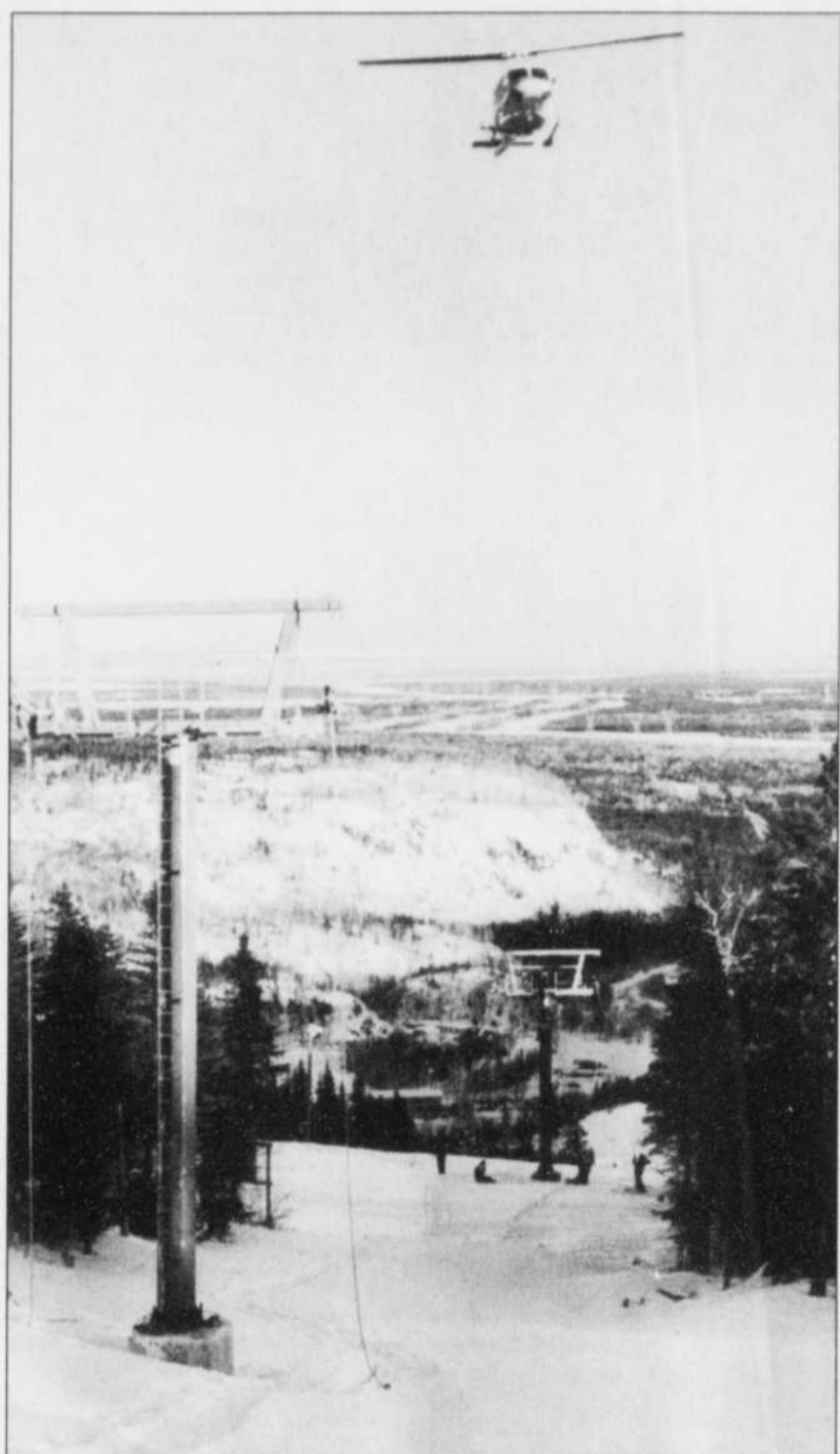
L'étape ultime de l'installation du télésiège était très spectaculaire. C'est avec l'aide d'un hélicoptère qu'on a procédé à la pose des principaux éléments.
