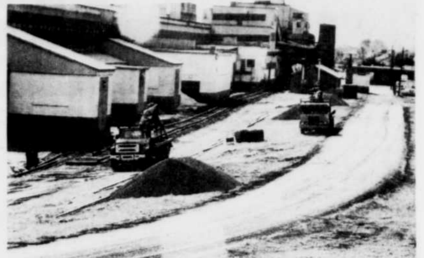
(Flageol Photo — Claude Deschamps) La compagnie Norton de la rue de Grandmont à Cap-de-la-Madeleine fait présentement effectuer des travaux de l'ordre de $60,000. Il s'agit en fait de remplacer près de 2,000 pieds de voie ferrée grandement endommagée par le poids des ans et des wagons. Il était devenu nécessaire de remédier à la situation de dire l'ingénieur Roger Morrisset et on refait la voie ferrée de fond en comble y compris les assises. C'est la firme madelinoise Cantrack qui a obtenu le contrat.
