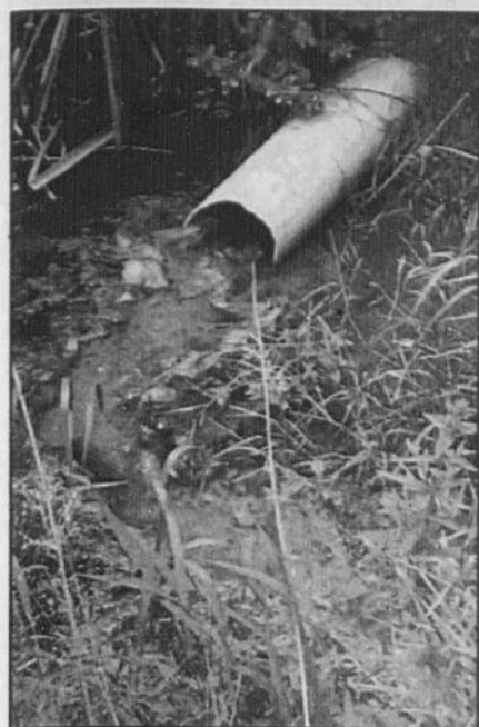
Les résidences des secteurs des Enclaves et Hollywood rejettent les eaux usées de leurs fosses septiques directement dans des fossés.
