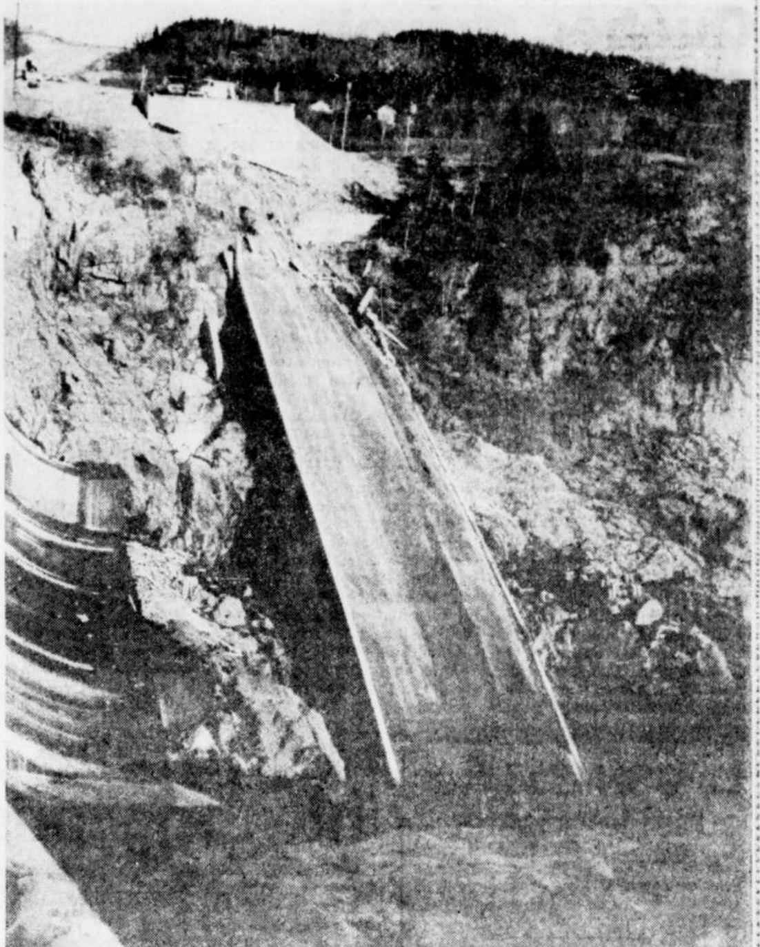
Un spectacle bien désolant que cette structure tordue et ce camion au fond du ravin.
