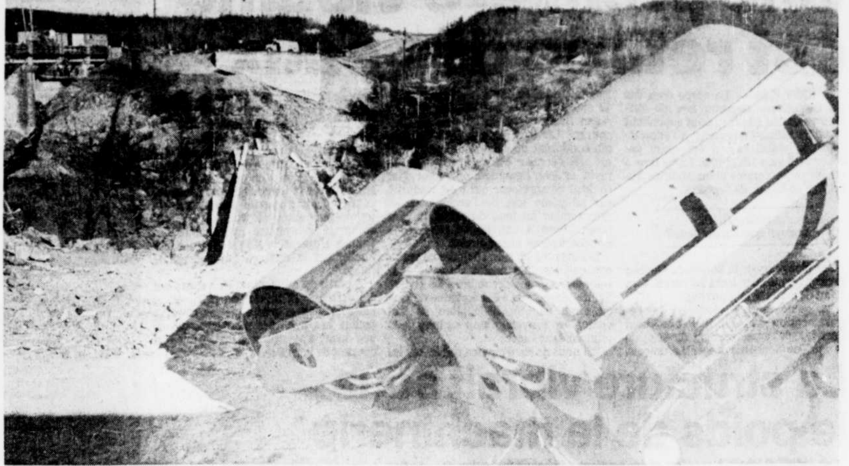
Un rouleau compresseur, renversé lors de l'effondrement du pont, a passé à un cheveu de se retrouver dans la rivière Sainte-Marguerite.
