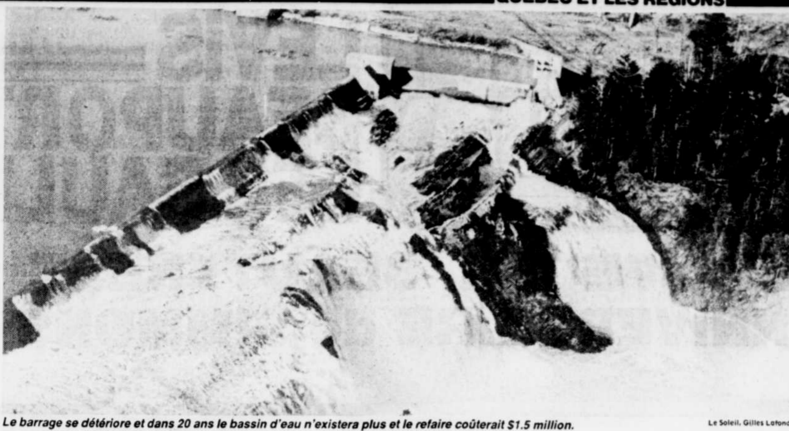
Le barrage se détériore et dans 20 ans le bassin d'eau n'existera plus et le refaire coûterait $1.5 million.
