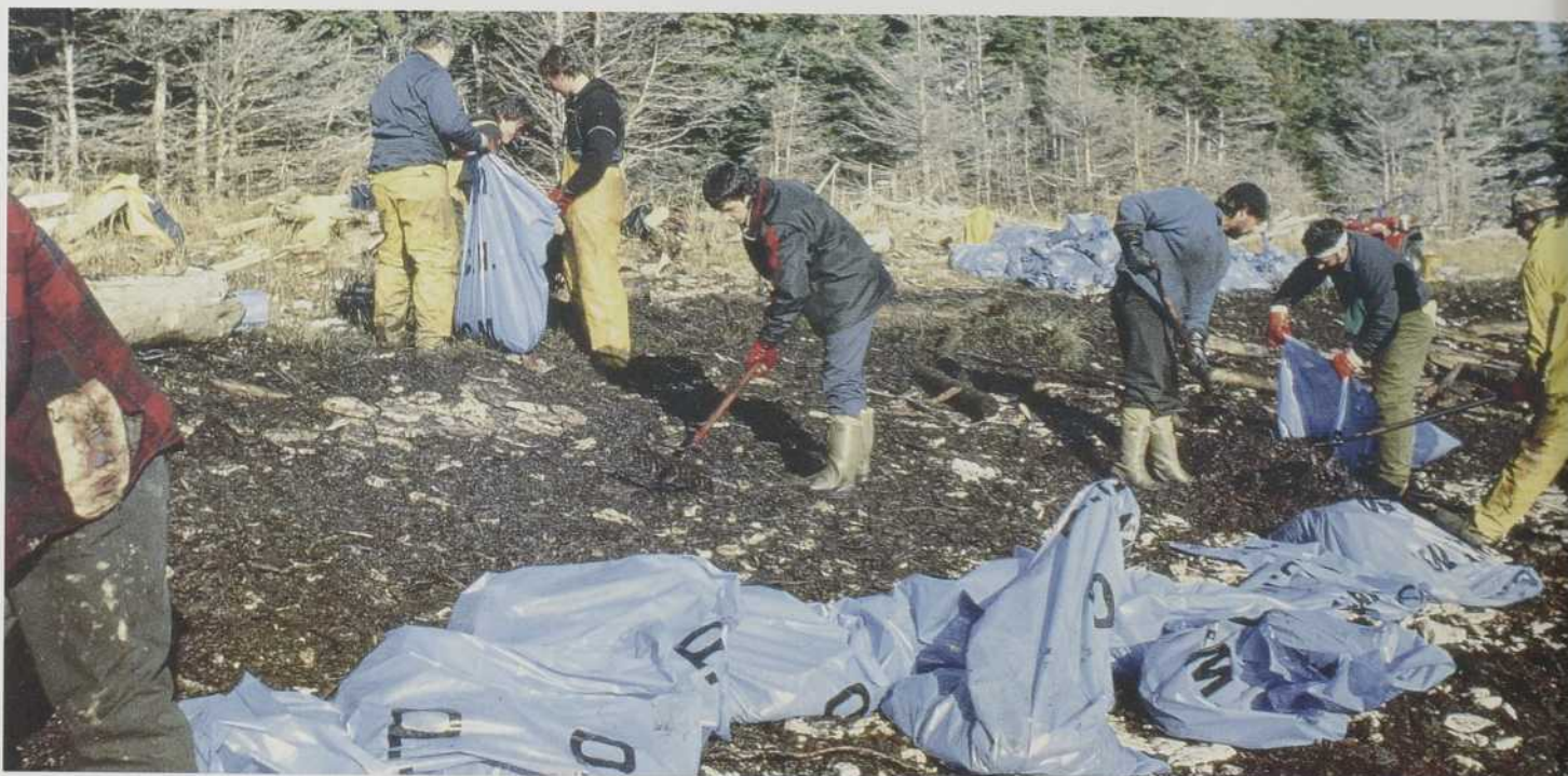
Après un déversement, les rives doivent être nettoyées à la satisfaction d'Environnement Canada et du ministère de l'Environnement du Québec.
