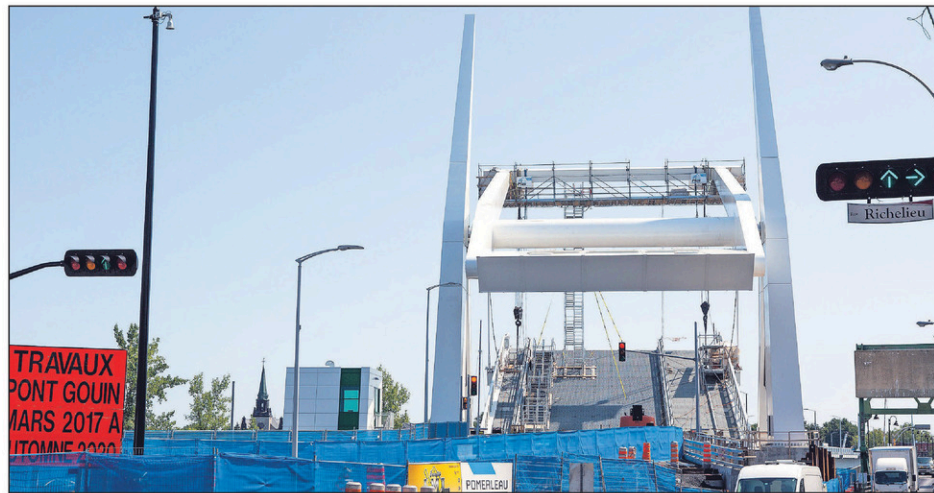
Un système de relèvement sera mis en place le temps de régler le problème des tirants.
