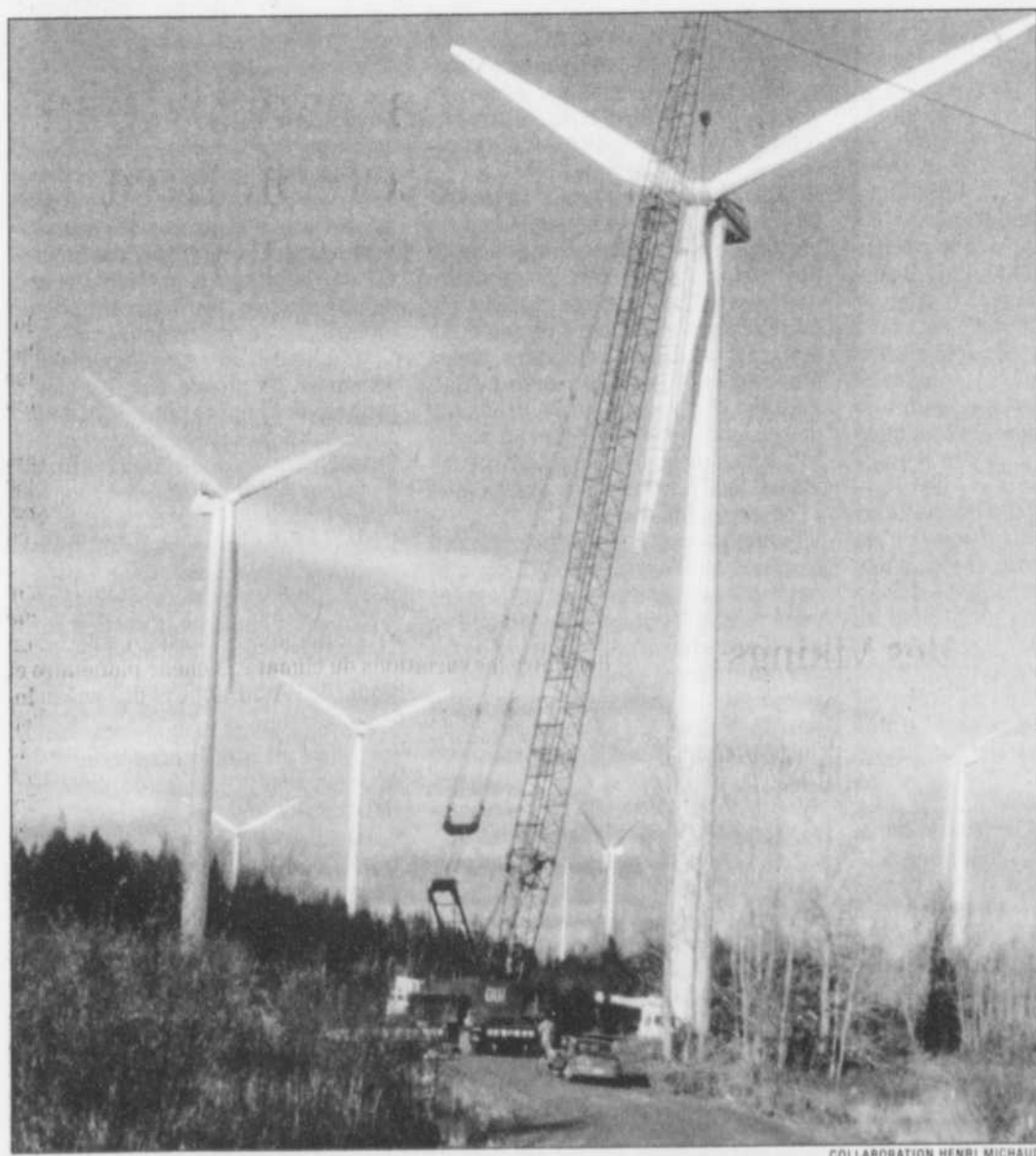
Le parc éolien de Cap-Chat, d'une puissance installée de 100 mégawatts, fournira bientôt 40 mégawatts de puissance continue à Hydro-Québec.
