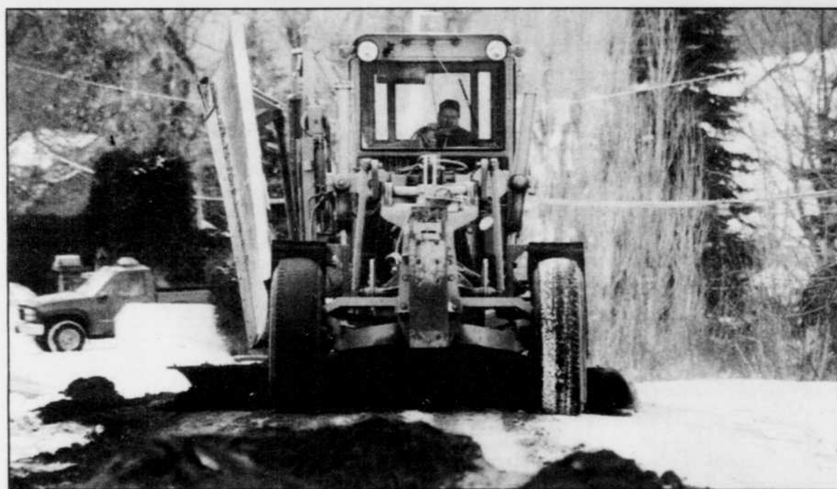
Ci-haut, une vue aérienne donne une bonne idée des dégâts à Adamsville. Et ci-contre, la machinerie lourde a dû intervenir pour réparer le chemin Centre à Iron Hill. photos Alain Dion
