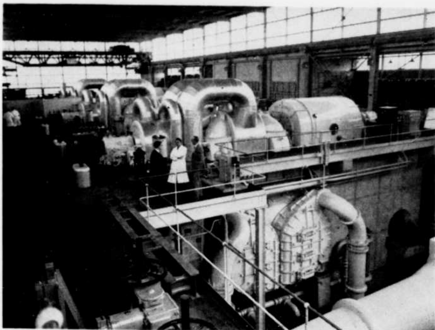
La salle des turbines à la centrale nucléaire de Calder Hall. Chaque turbo-alternateur peut produire 23,000 kilowatts d'énergie électrique.
