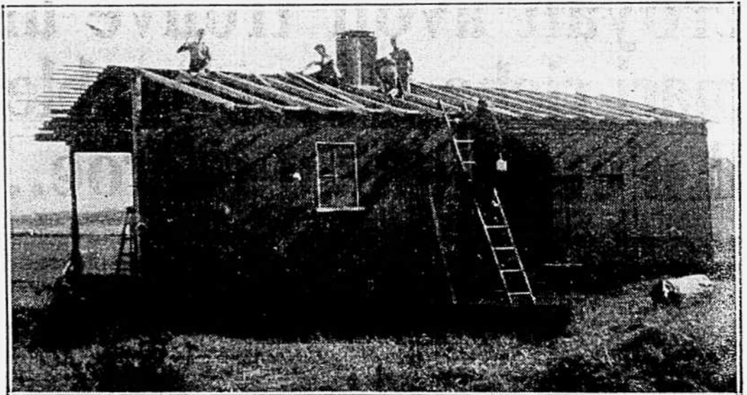
Cette photographie fut prise pendant le mois de septembre, alors que les scouts se dépêchaient de construire leur camp avant l'hiver. La cheminée est déjà fixée et la toiture est en bonne voie. On n'a pas encore eu le temps de rendre inamovible la porte à coulisse de l'un des anciens wagons à marchandises.
