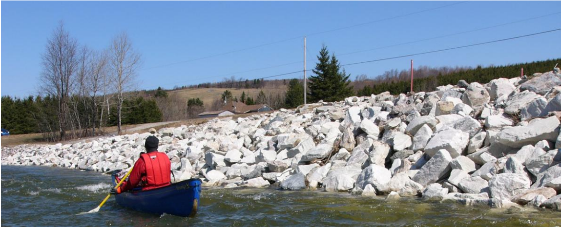
Stabilisation réalisée par le ministère des Transports afin de protéger l'assise de la route 263
