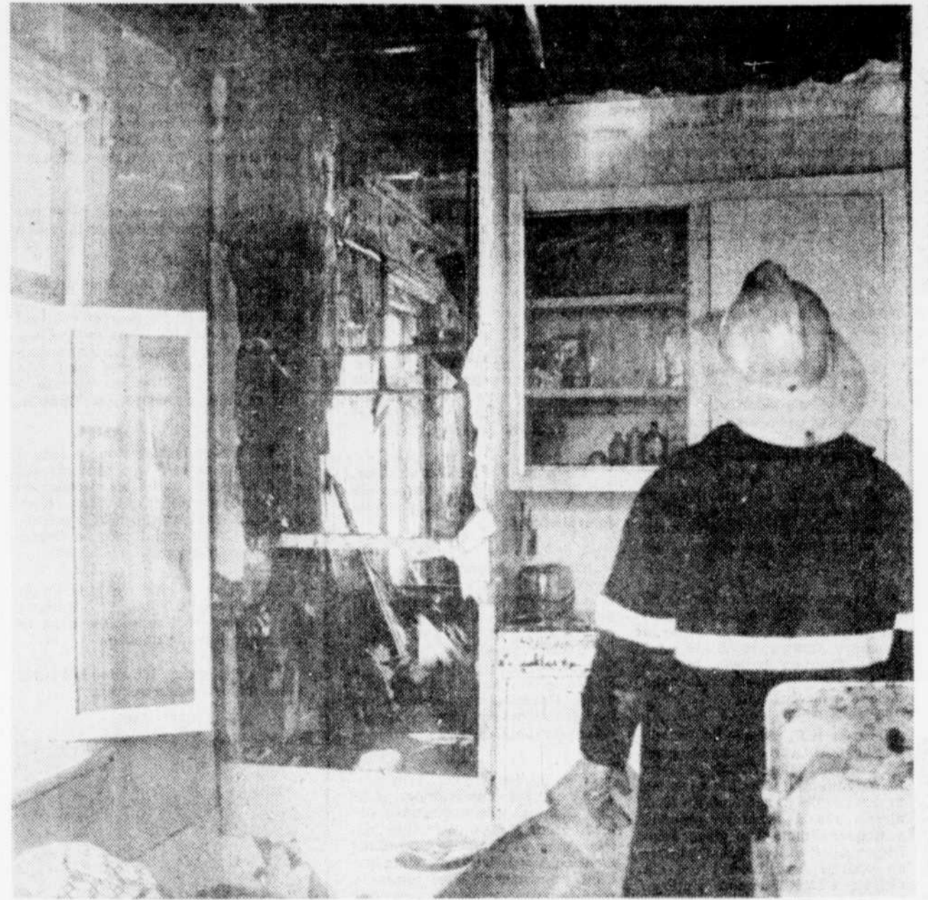
C'est dans cette partie de la cuisine que le feu a éclaté. Une partie des armoires a été consumée.
