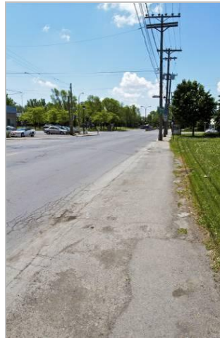
Trottoir discontinu face au Cirque du Soleil (2012)
