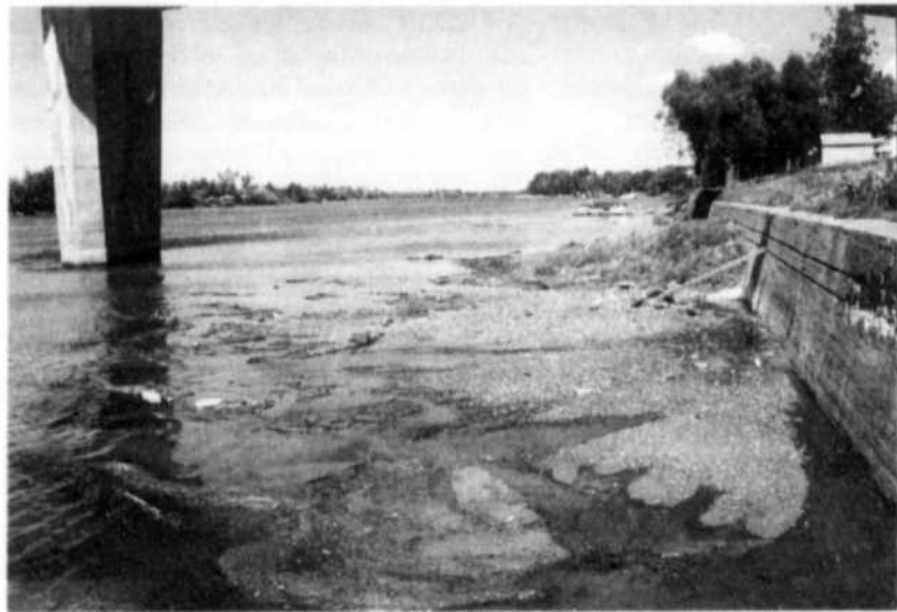
L'amoncellement de pierres, laissé pour une deuxième fois par l'eau qui s'est échappée de la conduite, a formé une «plage de roches» sur le bord de la rivière. (Photo L'Oeil Régional)
