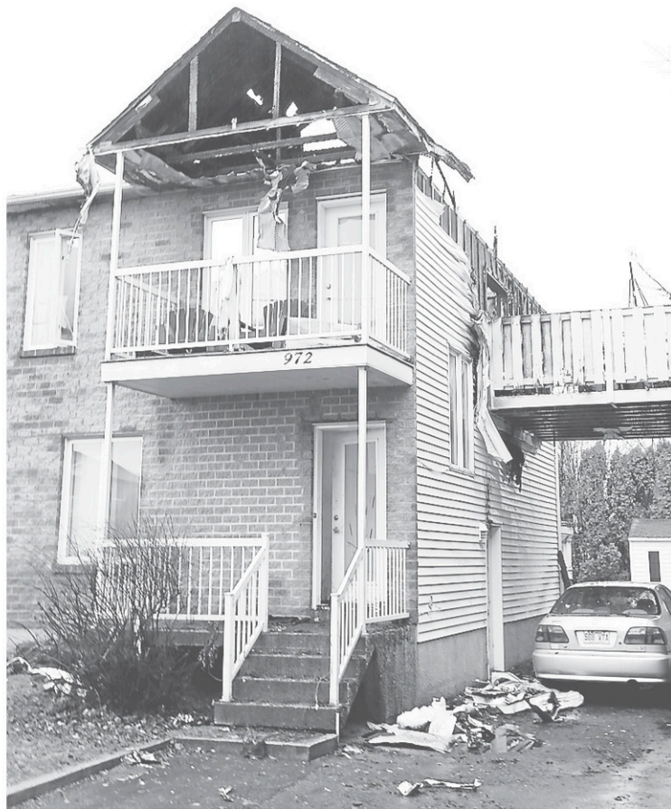
L'incendie d'un duplex de la rue Caron à Granby jette deux familles à la rue. Les dommages sont considérables. — PHOTOS JANICK MAROIS
