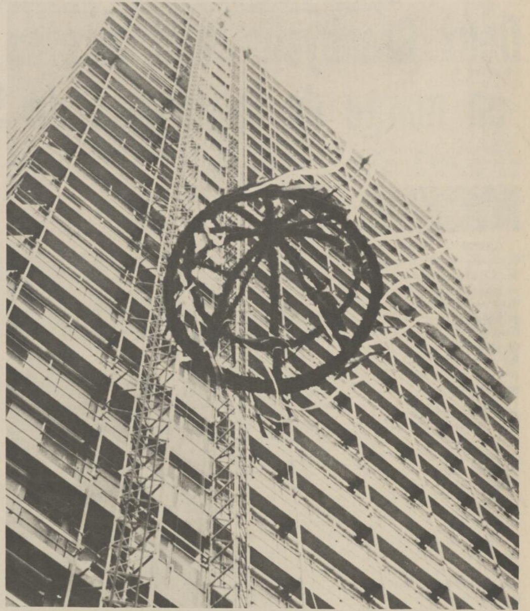
LE NOUVEAU BATIMENT de 29 étages qui va abriter le parlement de Bonn pourra accueillir les députés d'ici un an. La fête des maçons qui se déroule traditionnellement lorsque la charpente du toit est achevée a eu lieu en présence du président du Bundestag. L'immeuble surplombe tous les édifices de la ville et même le Venusberg, la plus haute colline de Bonn! Il coûte $12 millions.
