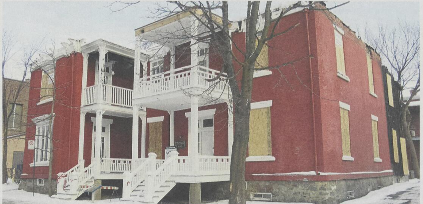
L'historique maison ayant appartenu à Georges-Casimir Dessaulles sera démolie en mars. Photo Patrick Roger | Le Courrier ©
