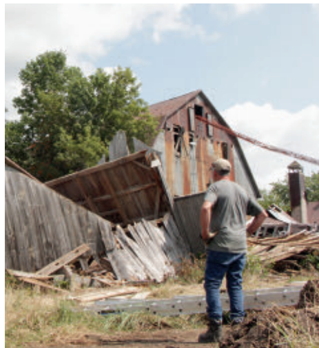
Roger Rémillard aide son fils David dans le travail de démantèlement des planches, des poutres et de la tôle de la grange qu'ils viennent de jeter à terre. La quasi-entière des matériaux pourra être récupérée.
