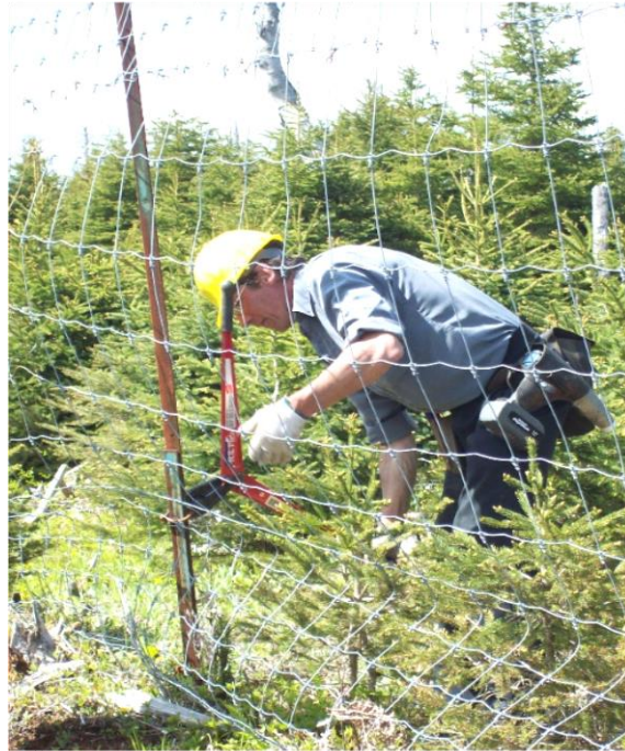
FIGURE 2 : COUPE DES BOULONS LORS DU DÉMANTÈLEMENT DE LA CLÔTURE
