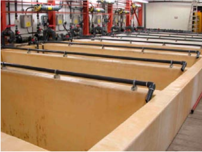
Photo 21. Vue sur les bassins de l'usine de dépuración.
