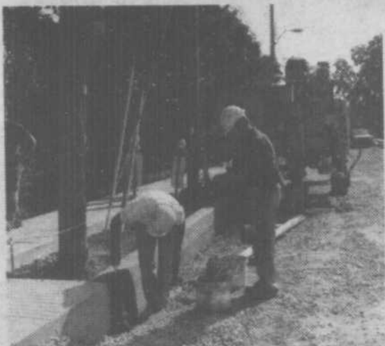
LA RÉFECTION DES BORDURES: Sur la rue St-Alexandre, alors qu'on procédait mardi dernier au coulage des bordures à l'aide d'une machine à extrusion. On a pu, sur quelques chantiers, avoir recours à cette méthode plus moderne que celle du coulage traditionnel de béton dans des formes qu'on doit par la suite démouler. Ce procédé, par vibrations, moule le béton à l'intérieur même de la machine et dès après son passage, là où il n'y avait que du gravier, une nouvelle bordure toute fraîche commence déjà son séchage.
