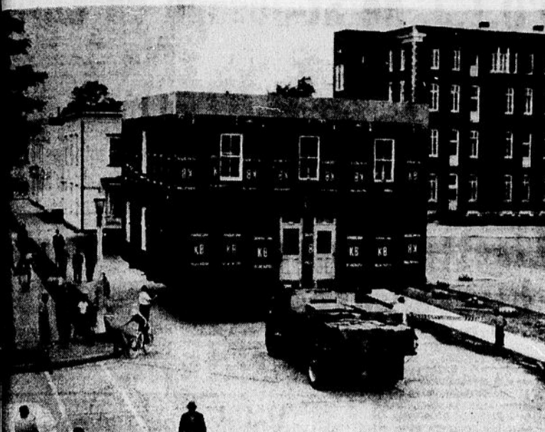
LES TROIS MAISONS qui occupaient l'emplacement où doit être construit le nouveau bureau de poste de Grand'Mère ont été démolies, jeudi après-midi, de par les de la ville. Elles avaient été acquises par M. Gérard Villemure, agent d'immeubles de Grand'Mère, avant que les transactions en vue de la construction d'un bureau de poste à Grand'Mère soient complétées par la succession de Mme Napoléon Deshaies et de Mme Nérée Lambert. C'est l'entrepreneur en déménagement de maisons, M. Pierre Bellemare, de Trois-Rivières, qui a procédé au dégagement du terrain. Les maisons ont été achevées sur la 7e Rue jusqu'à la 3e Avenue, puis elles ont été dirigées vers le sud sur la 3e Avenue où elles seront renouées et offertes à loyers. Cette photo nous montre les trois maisons et nous pouvons apercevoir à droite le collège Sacré-Coeur de Grand'Mère.
