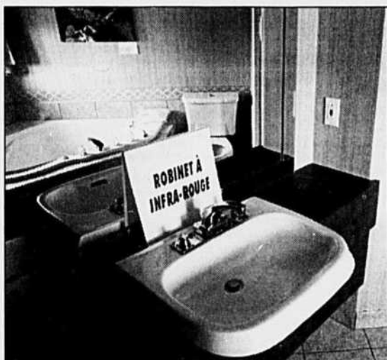
Pour éviter de faire couler l'eau pour rien, les robinets (autres que ceux de la baignoire) comportent des cellules photo-électriques: l'eau coule seulement lorsqu'on passe la main devant.
