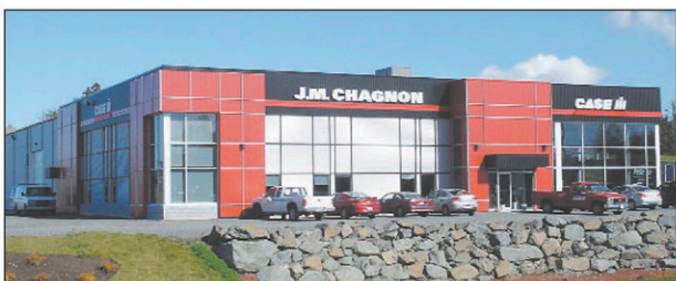
L'équipe de R.T.S.I. a effectué le revêtement de l'entreprise J.M. Chagnon, à Coaticook.
