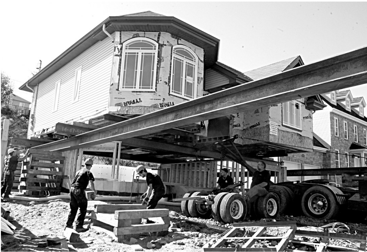
Trois des six demeures de la rue Lafrance ont été déplacées à quelques rues de leur emplacement original.
