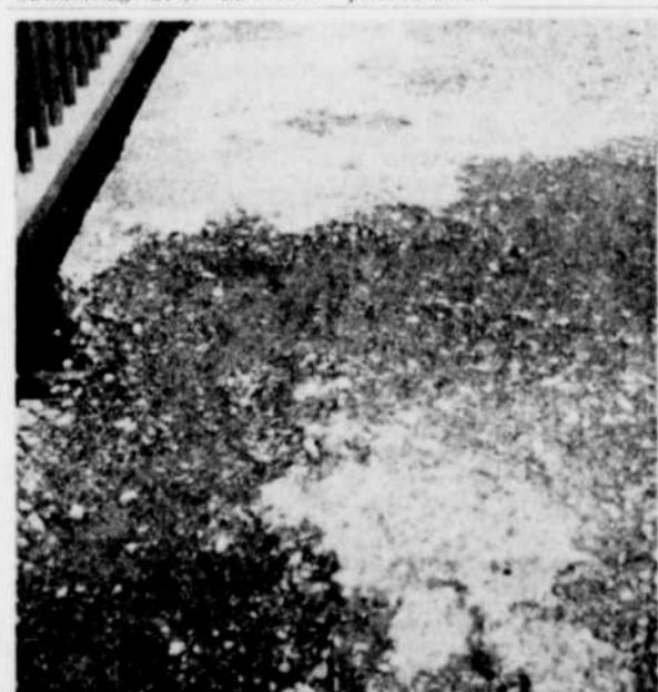
ENCORE LES TERMITES! — Les piétons empruntant les trottoirs du pont Montcalm ont sûrement raison de se demander si les termites sont à l'oeuvre. Si le béton continue à se désagréger, le tablier du pont fera son apparition. (Photo La Tribune, par Studio Breton)
