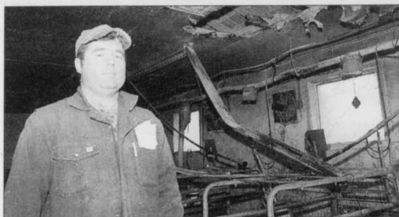
L'incendie a endommagé une partie du plafond d'une porcherie de Stukely Sud, jeudi soir. Les dommages sont évalués à plus de 25 000 $.
