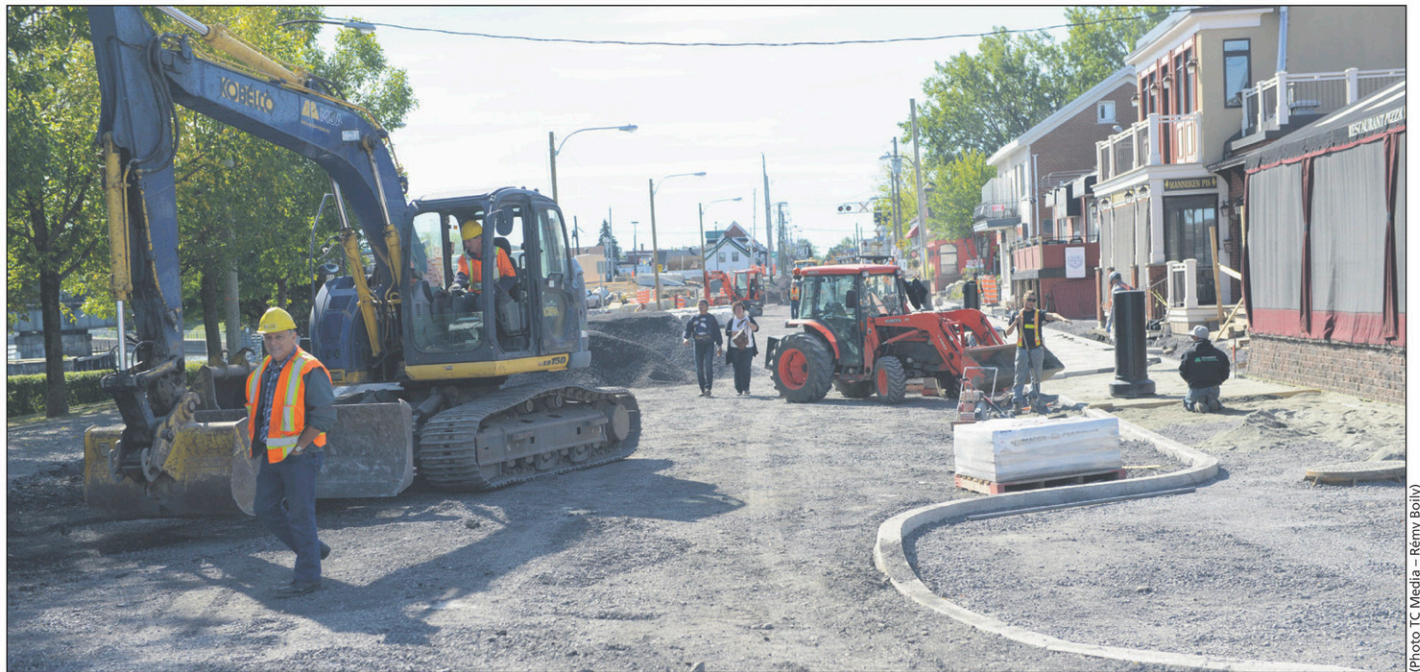
Un projet comme celui de l'entrée nord permet de réduire le volume d'eaux usées acheminé à l'usine d'épuration. C'est un crédit pour développer ailleurs.
