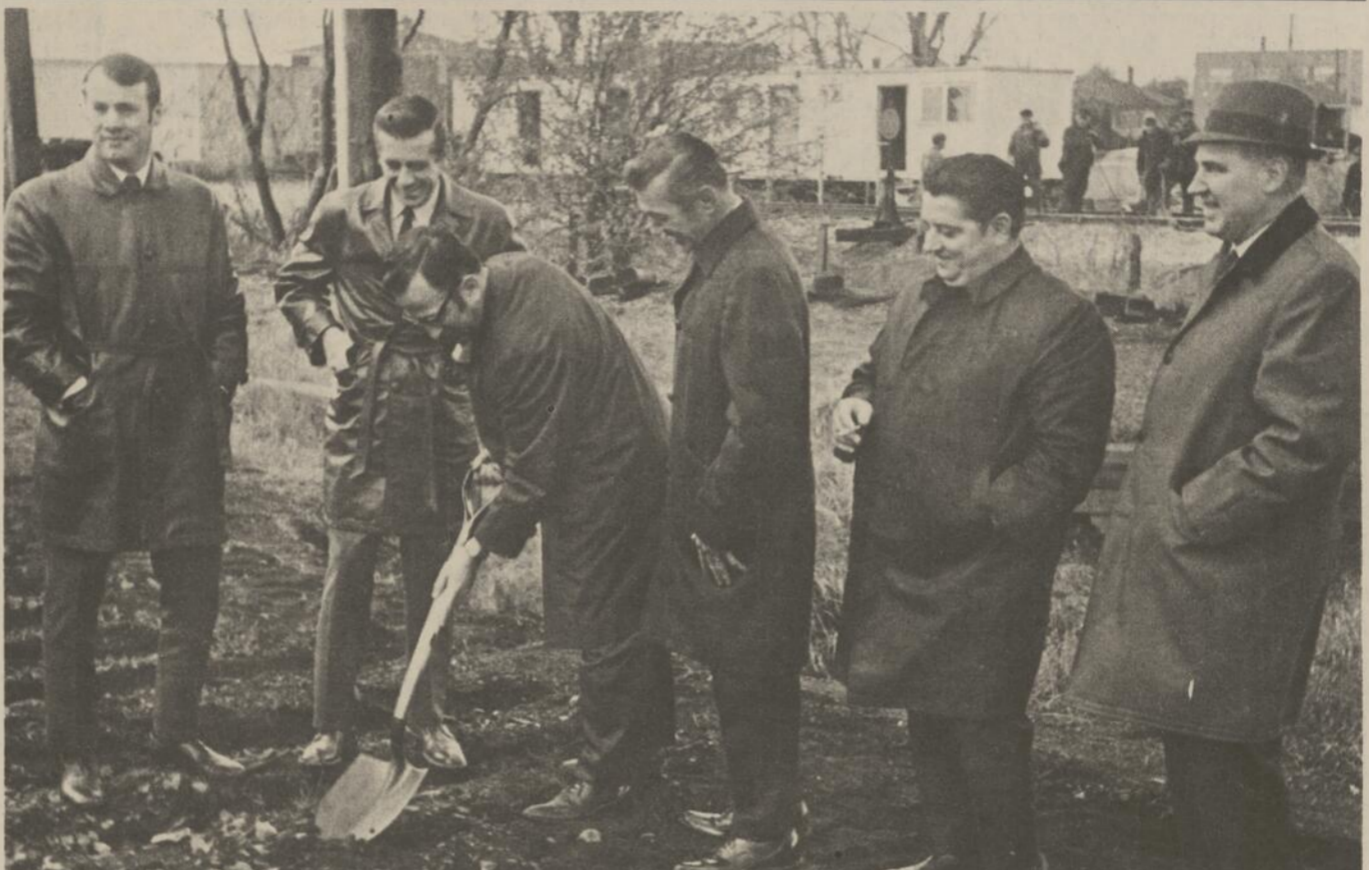
TUNNEL CHOQUETTE -- C'est avec une satisfaction évidente que les dignitaires maskoutains ont inauguré les travaux de construction du tunnel de la rue Choquette. On reconnaît dans l'ordre autour de M. Denis Bousquet député provincial local qui lève la première pelletée de terre.
