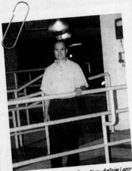
Le chef de la Division des eaux de Repentigny, Antoine Laporte, estime qu'il n'y a pas urgence à aménager de nouvelles réserves bien qu'il faille commencer à y songer. Quant à la capacité de production, aucun problème sur un horizon de 10 ans. (Photo: Martin Gauthier)
