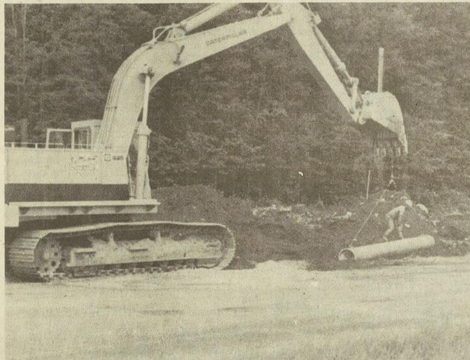
Sur la rue Georges Cros, dans le parc industriel, on procède à l'installation de conduites d'égout et d'aqueduc.
