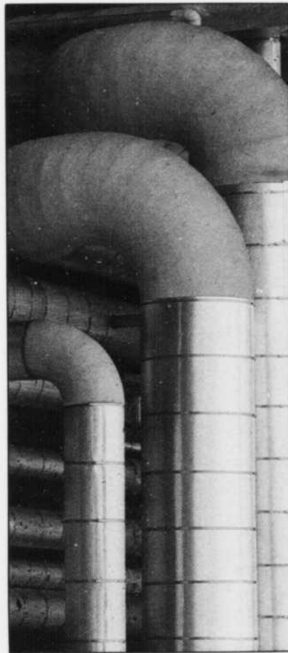
4 L'A.R.E. tient compte des contraintes d'espace dans la détermination de la quantité d'isolant à prévoir sur chaque canalisation en vue d'optimiser la rentabilité de votre placement.
