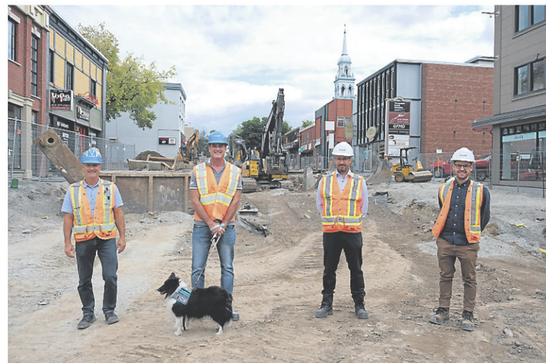
L'agent de liaison sur le chantier, Jean Breton, le maire Pascal Bonin, le directeur du bureau de projets à la Ville, Daniel Surprenant et l'ingénieur de projets, Patrick Nicol, affirment que les travaux se déroulent rondement. — LA VOIX DE L'EST, ALAIN DION
