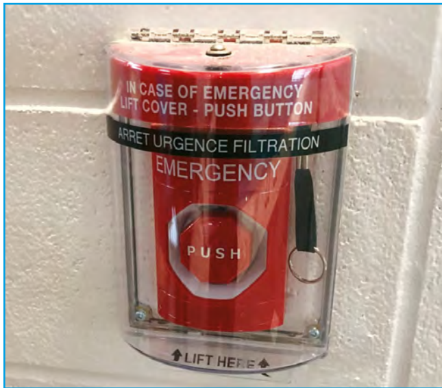
● Figure 46. Interrupteur d'urgence du système de filtration d'une piscine
