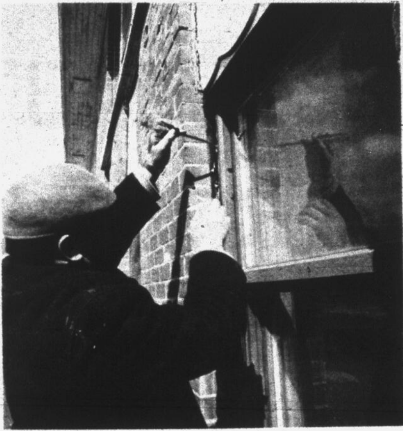
A l'arrière le mur extérieur s'écarte d'au moins deux pouces de la ligne verticale de la bâtisse.
