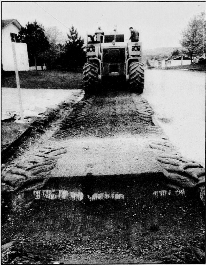
Le pulvérisateur «CMI RS 500» récupère le vieil asphalté et la couche de gravier que l'on retrouve dessous.
