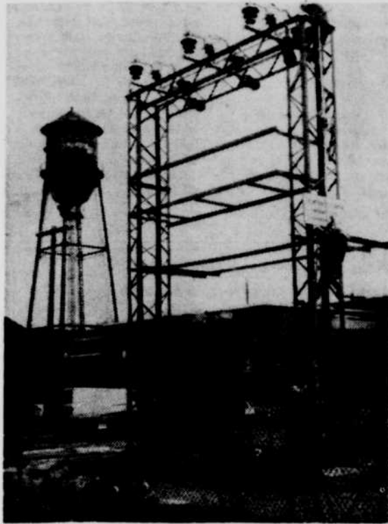
La sous-station électrique de Drummondville...
