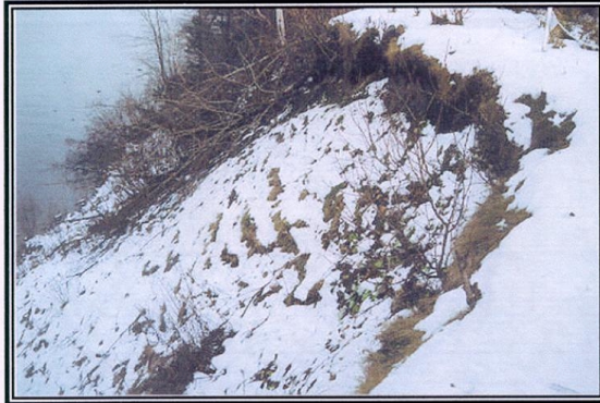
PHOTO 2 : Vue d'un effondrement d'un secteur en surplomb.
